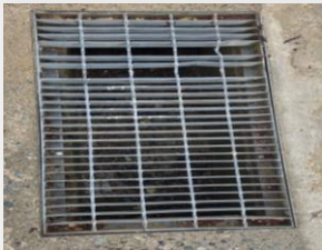
용접 구간 떨어짐
